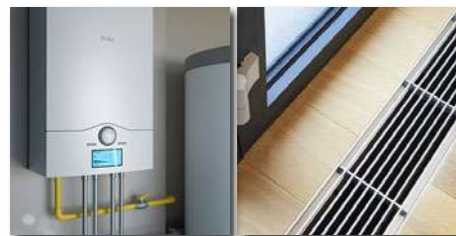
автоматизация на котли автоматизация на подово отопление
